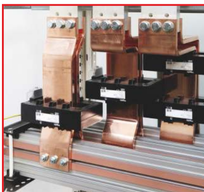
Podłączenie wyłącznika głównego dwiema szynami miedzianymi 2x80x10
